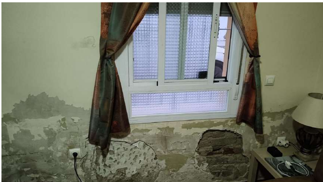
La pared de una de las viviendas afectadas tras las obras en Bajamar.
