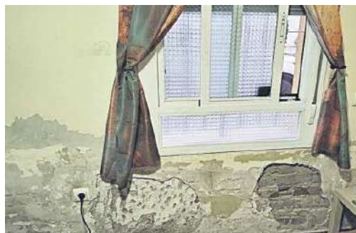
La pared de una de las viviendas afectadas tras las obras en Bajamar.
