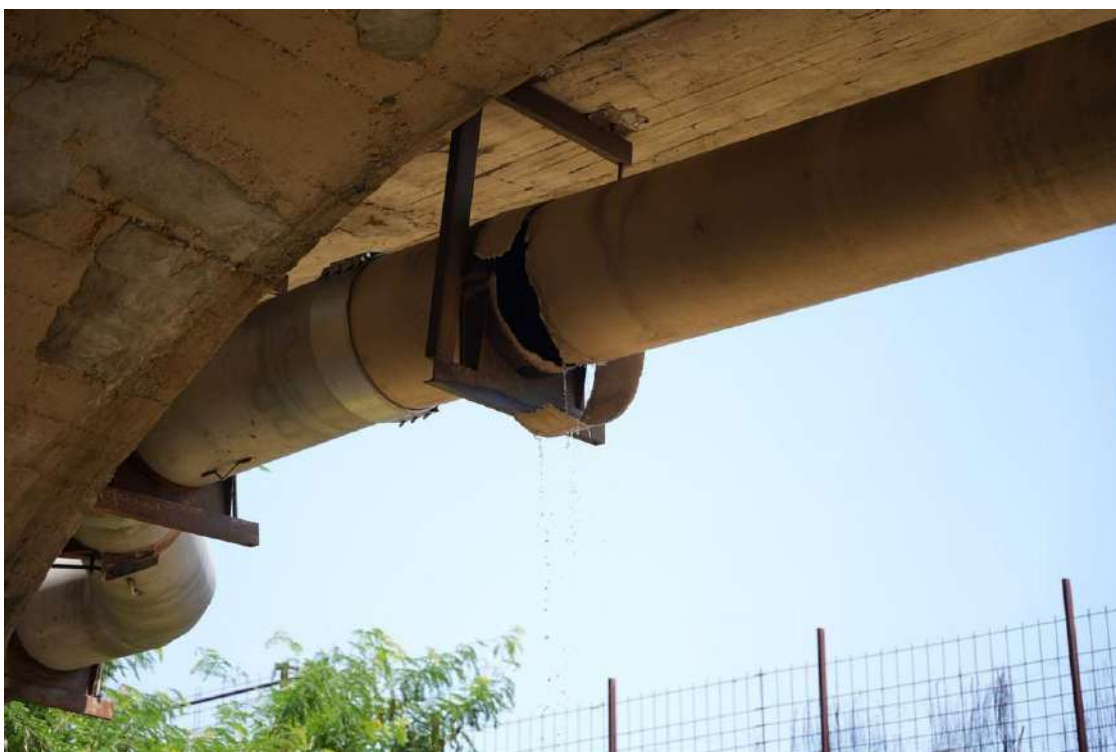
Imagen de la rotura de la tubería que cruza el puente de la Universidad de Badajoz. / Diego Rubio Paredes
