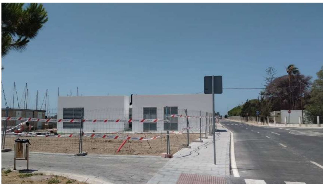
Los módulos que sustituyen a la antigua estación de bombeo.
