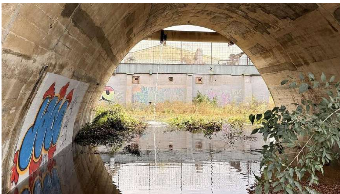
Imagen del inicio de la avería en una de las tuberías principales de Badajoz. / Concha Corrales
